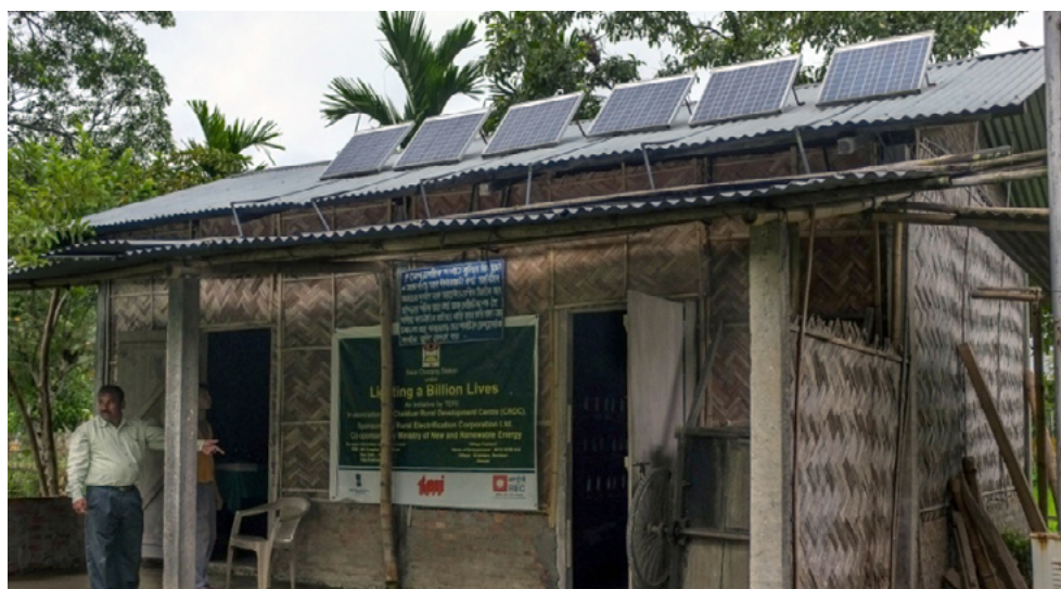
Installation solaire photovoltaïque non centralisée pour l'électrification des zones rurales
